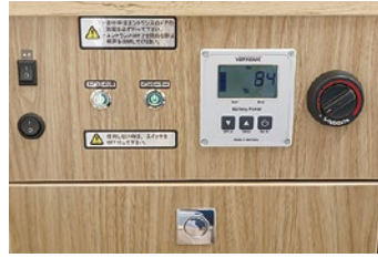
バッテリーコンピューターで使用電流やバッテリー残量を把握できます。隣にはメインスイッチとインバータースイッチが配置されています。
