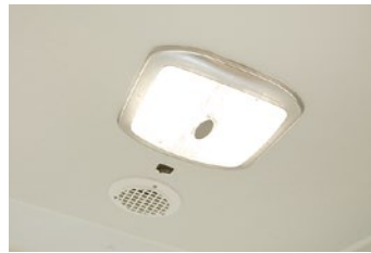
フリールームには照明と小型の換気扇が装備されます。
